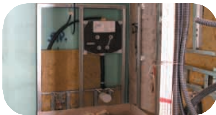
Supporti sanitari all'interno della Galleria Barchetta
